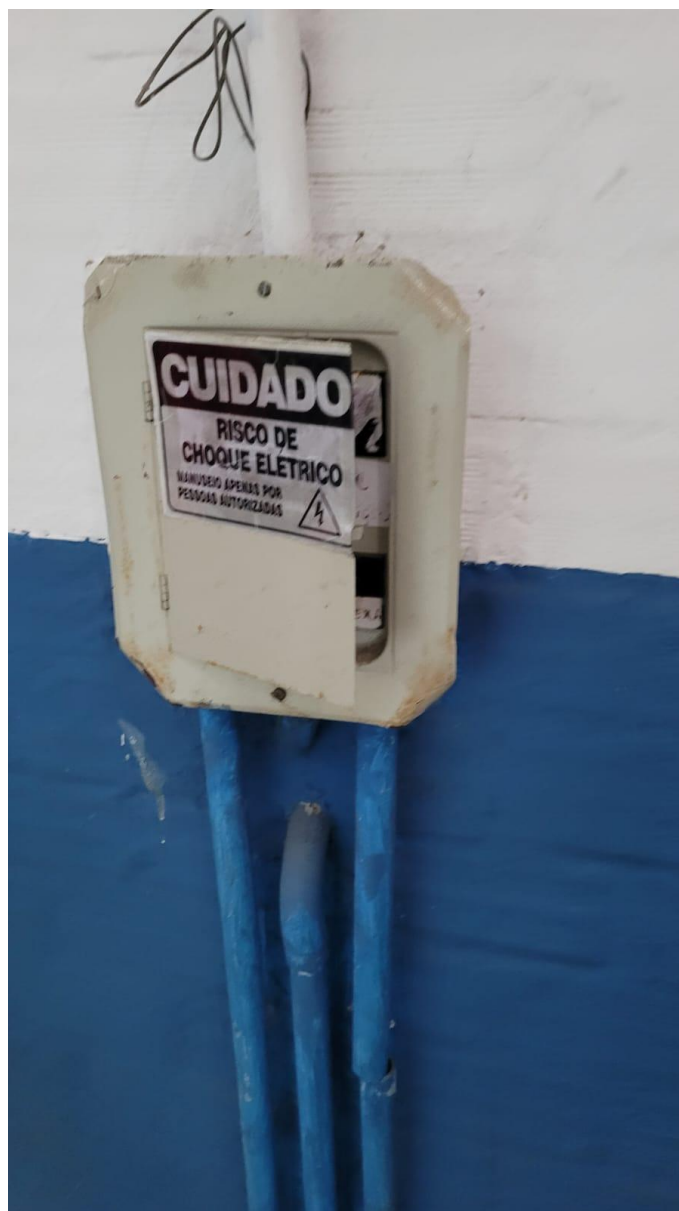
Fig. 02 - Verificou-se a existência de uma caixa de distribuição de energia aberta, e de fácil acesso.
