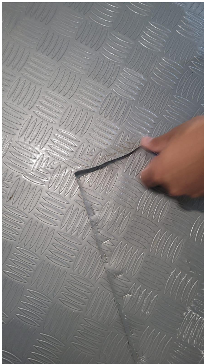
Fig. 03 - Verificou-se que o piso está descolando em várias partes, em especial próximo a área chamada “gourmet”, próximo a saída lateral e no meio do ginásio, onde fica o “pátio” da escola.
